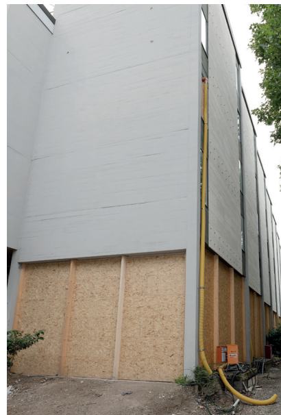
Die Arkaden sind mit Pressspanplatten verkleidet, um das Gebäude zu schützen. © Maximilian Borchert
